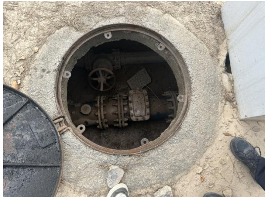
再生水进厂管道
